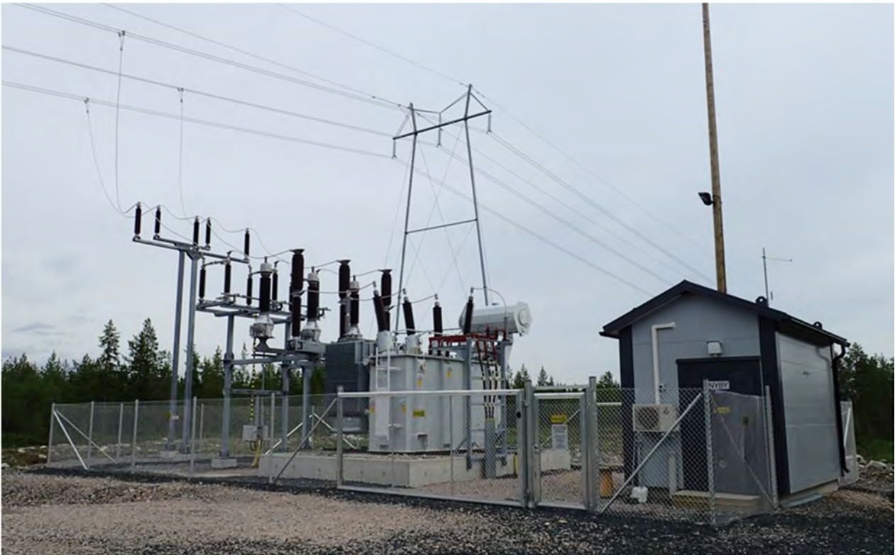
Kuva 68. Esimerkki tuulivoimapuiston sähköasemasta (kuva Minna Takalo/FCG).
