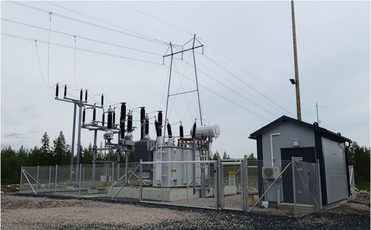
Kuva 69. Esimerkki tuulivoimapuiston sähköasemasta (kuva: FCG).
